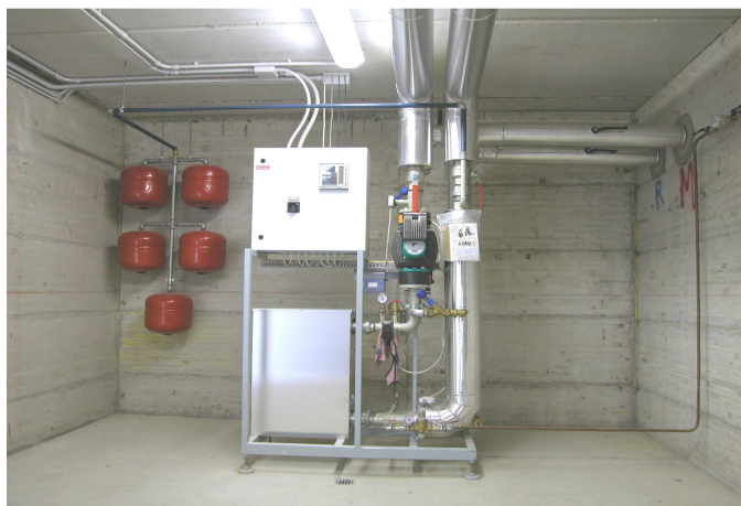
Fig. 2 : Sottostazione di scambio termico
